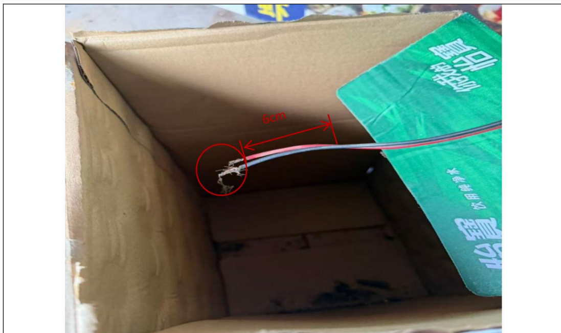
图 9 涉事电源线线头铜芯裸露情况
