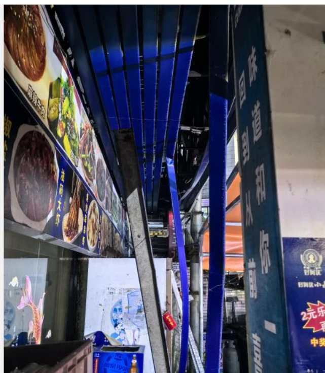
图 5 外挑走廊彩钢板吊顶局部坍塌损坏情况
