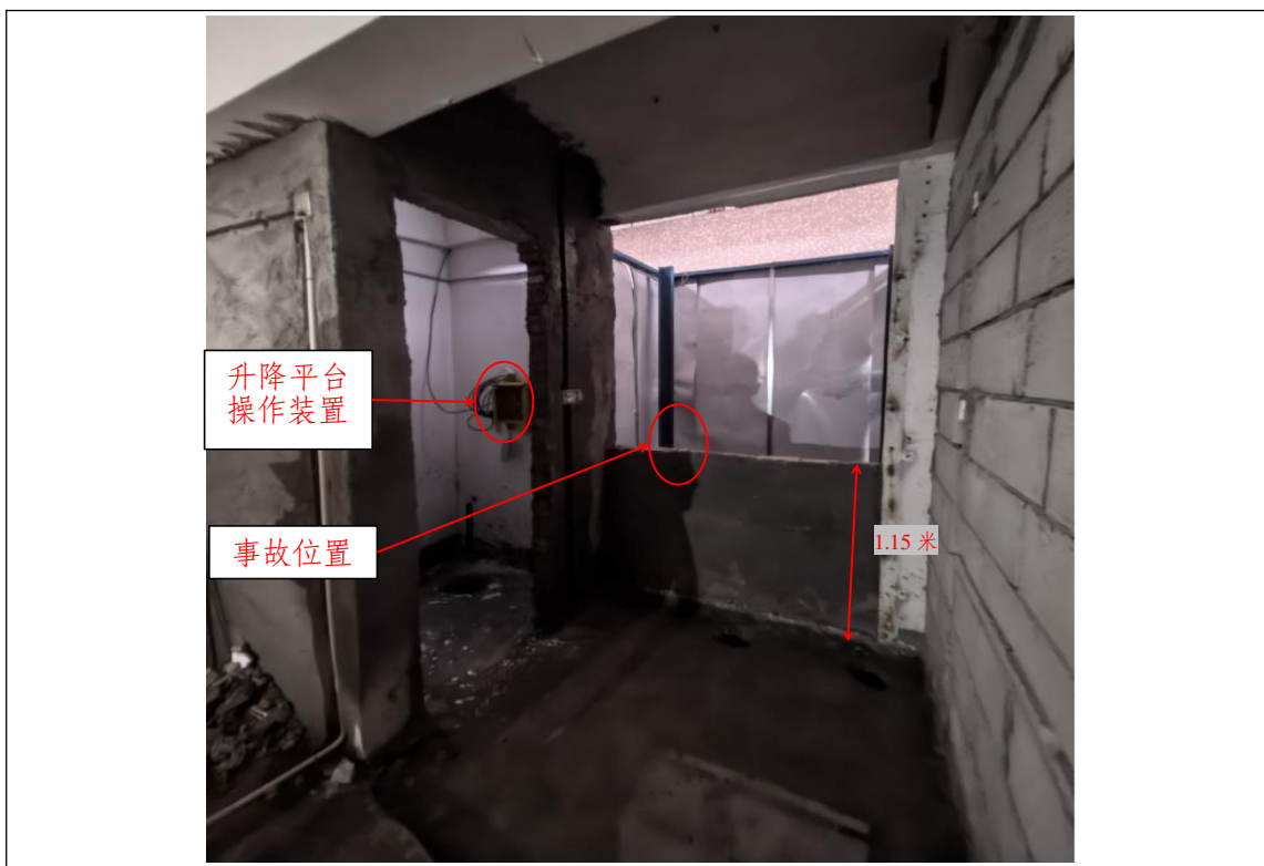
图 3 事故发生在三楼公寓阳台（原升降平台三楼出入口）
