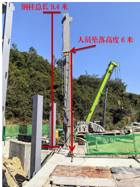
图 5 施工现场坠落情况
