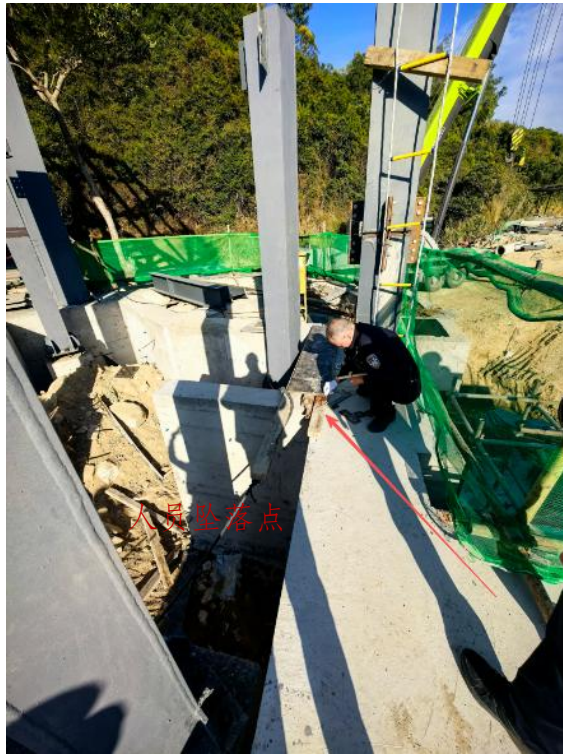
图6 事故现场技术勘查情况
