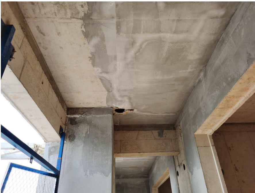
图 2 斜坡正上方楼层顶板有抹灰痕迹
