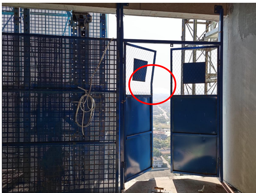
图 3 左侧楼层防护门上部弯曲变形较严重,两扇门均向外开启
