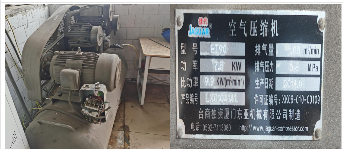
图6 空气压缩机照片
