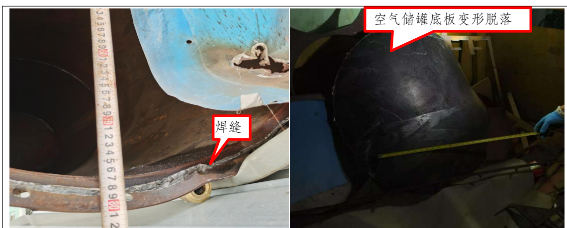
图 3 空气储罐及封板照片
