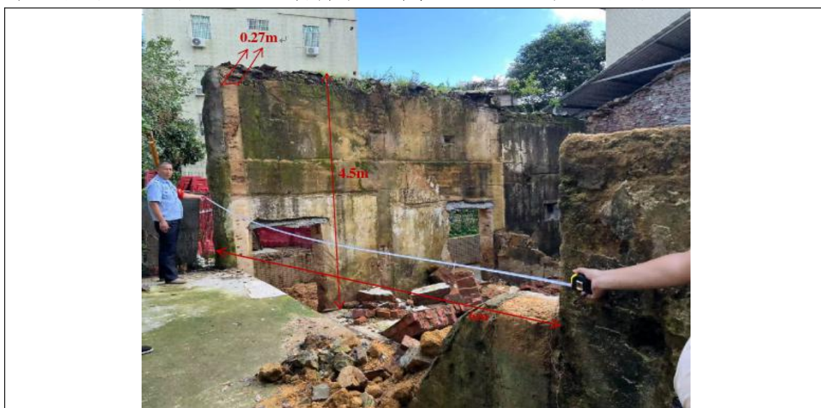
图3 西侧倒塌山墙
