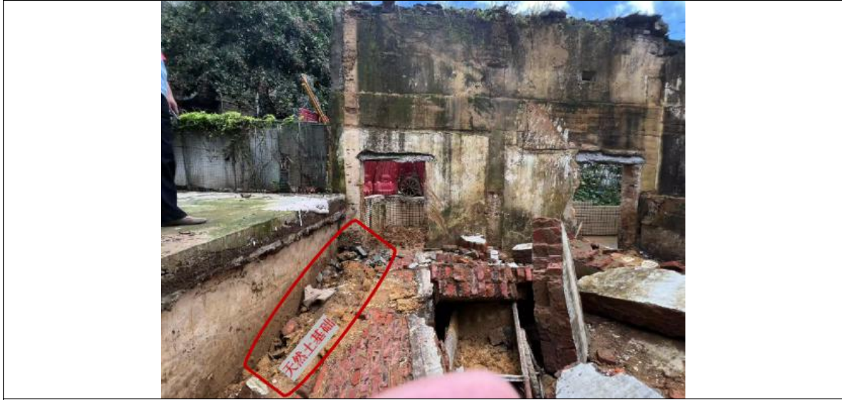
图6 涉事墙体基础为天然土地基
