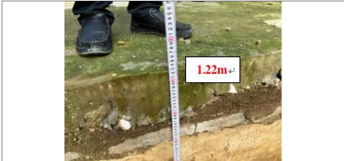
图 4 墙体距地面高差 1.22m
