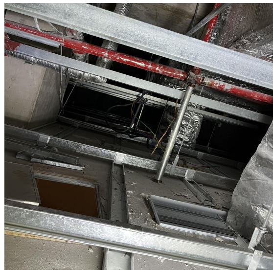
图 3 2 号体育器材设备间天花吊顶内安装的空调管线及未连接的电源线
