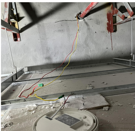
图 4 吊顶内应急灯电源线驳接处松脱
