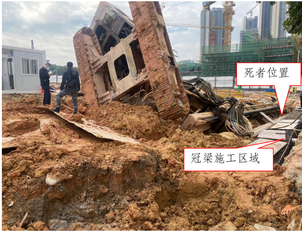
图 2 事故现场冠梁施工和旋挖钻机侧翻状况
