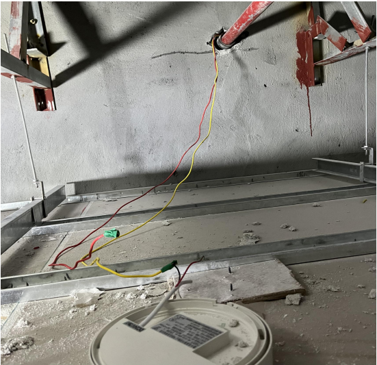
图 4 吊顶内应急灯电源线驳接处松脱
