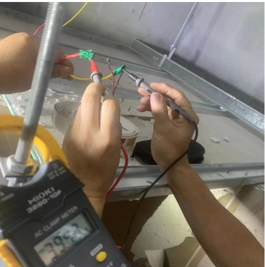
图 5 更换保险丝盒后，应急灯电源线驳接处电压为 39V 左右。
