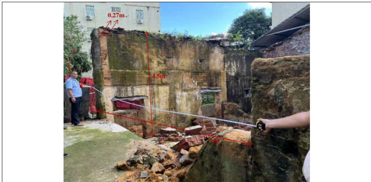
图3 西侧倒塌山墙
