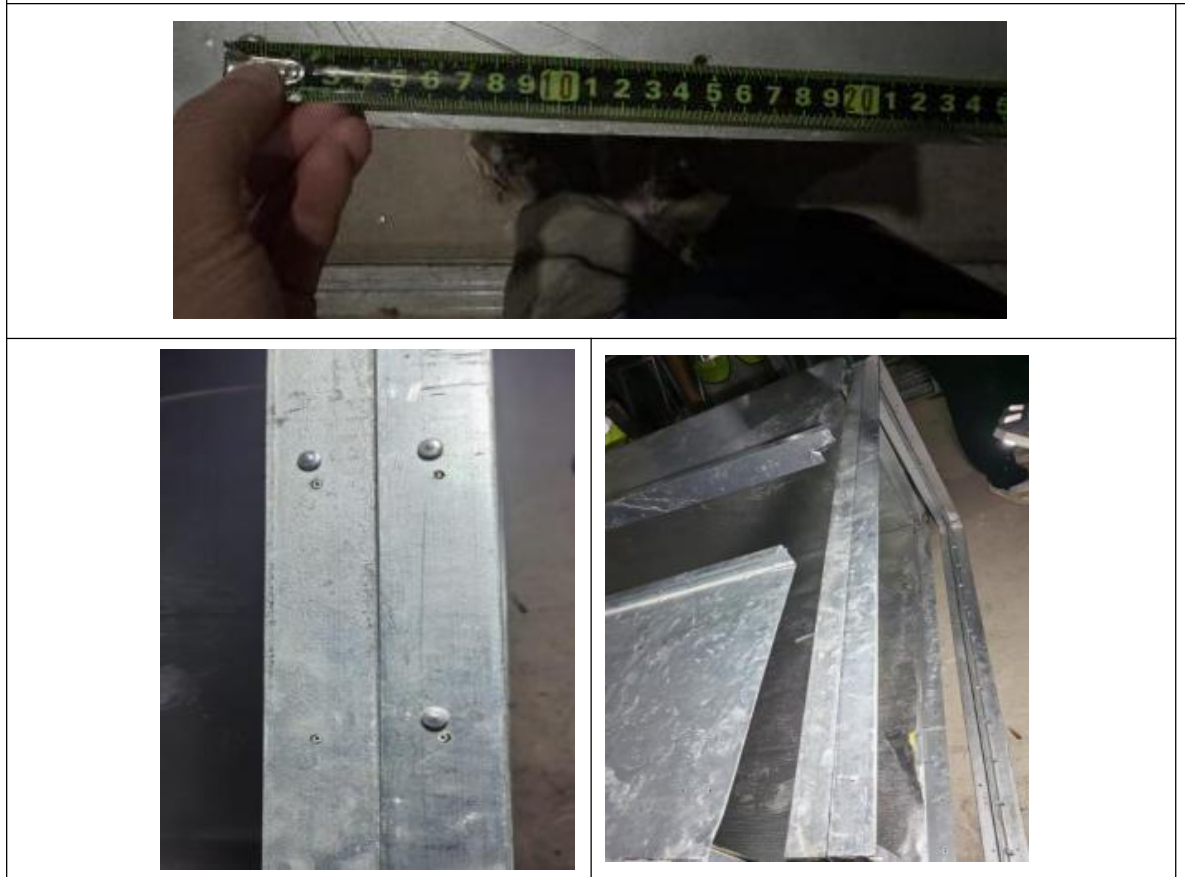
图 5 铆钉间距及脱落情况
