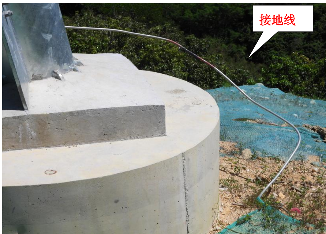
图3 JN5铁塔基脚接地情况图
