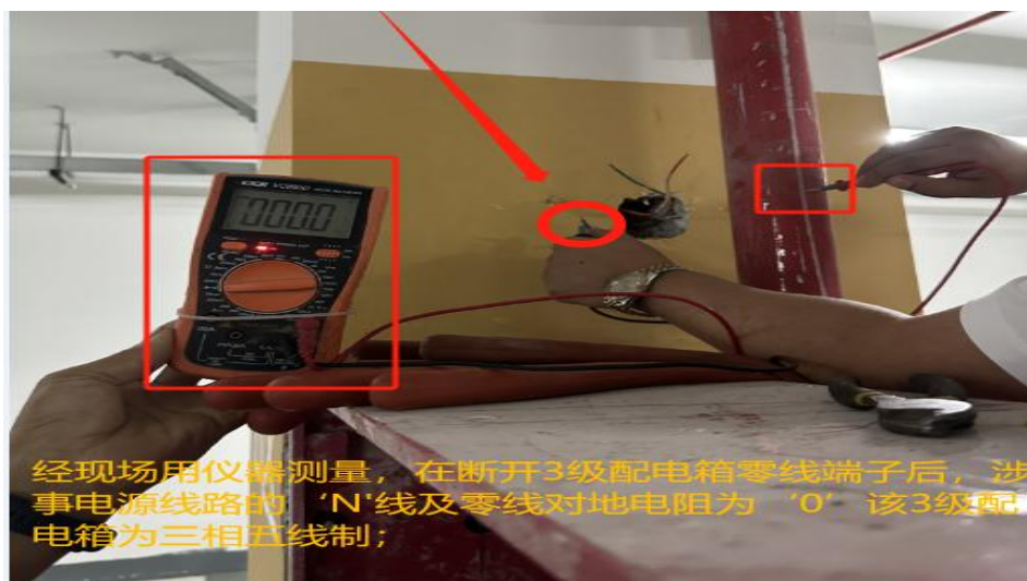
图6 零线（N线）与消防水管相通检测情况
