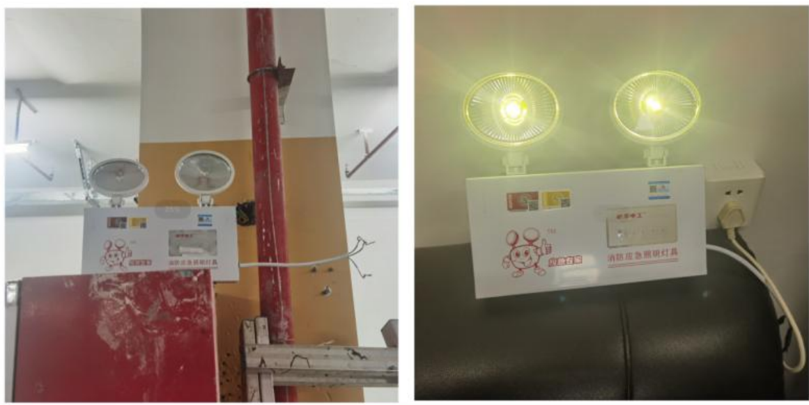
图 4 应急照明灯具摆放位置及测试情况
