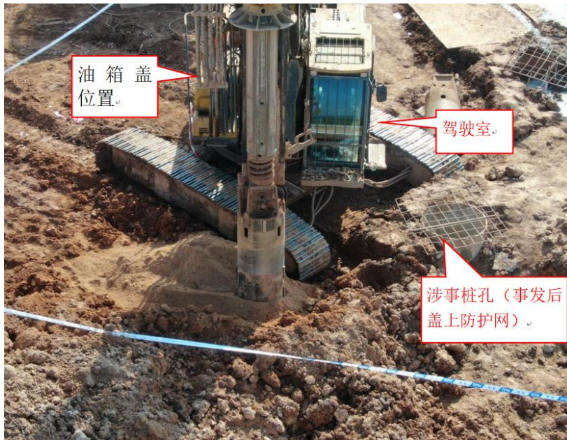
图 2 旋挖钻机驾驶室、涉事桩孔、油箱盖位置图
