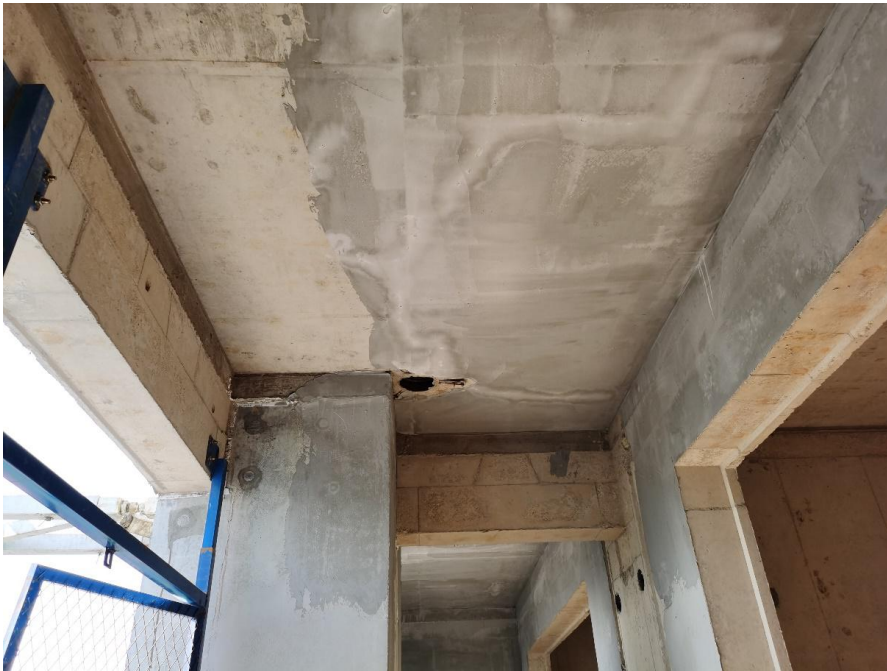
图 2 斜坡正上方楼层顶板有抹灰痕迹
