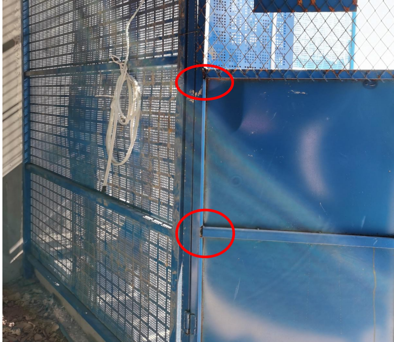
图 4 左侧楼层防护门两处横向骨架与纵向骨架焊接处开裂
