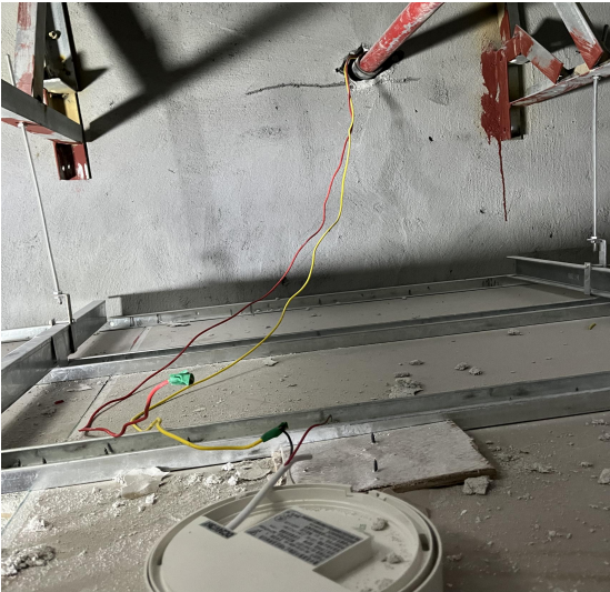
图 4 吊顶内应急灯电源线驳接处松脱
