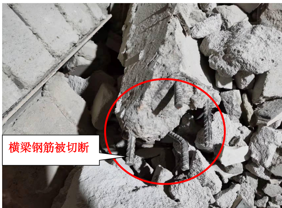
图 6 横梁钢筋被切割现场情况照片
