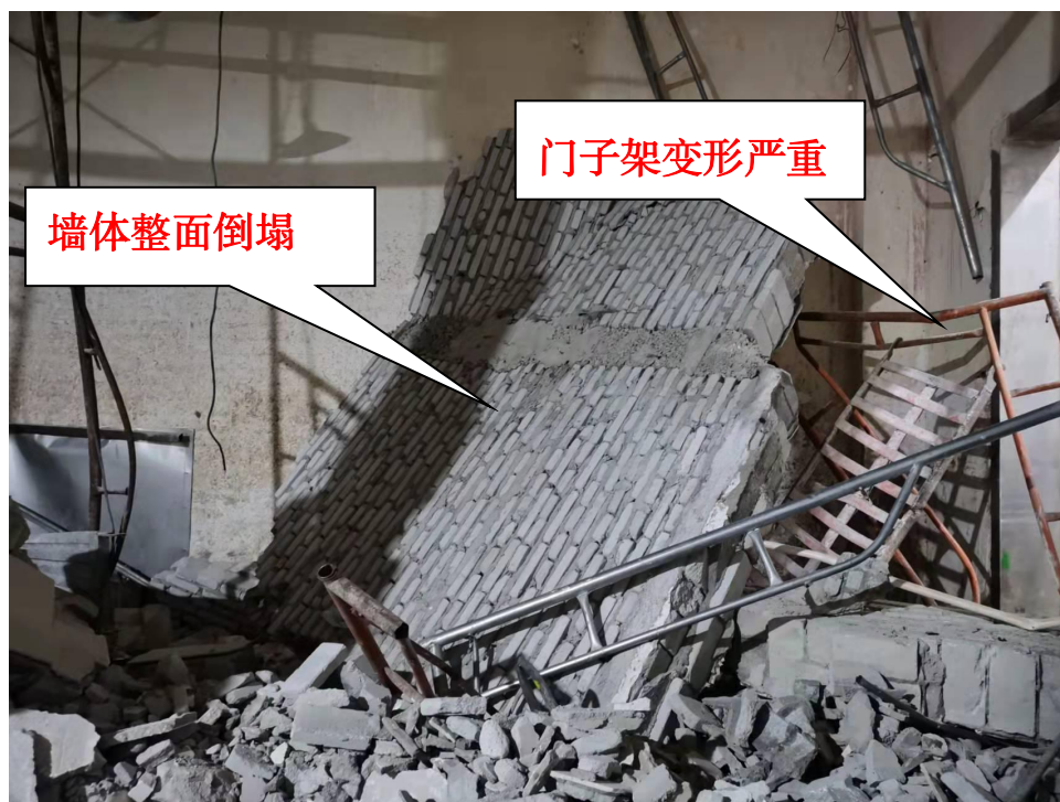
图 4 倒塌墙体现场情况图
